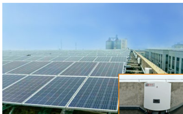
Changzhou Vaillant 2MW
